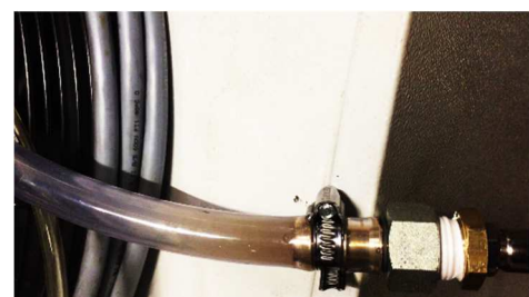
Abbildung 2: Trübung in Schlauchleitung während der Reinigung
