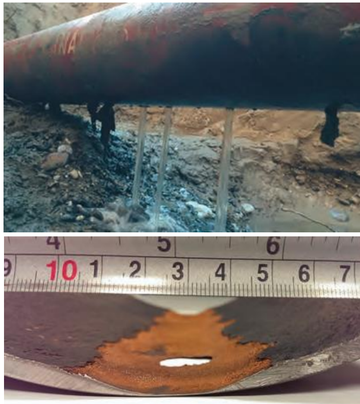
Rohrdurchbrüche infolge von Abrasion durch Grobpartikel im Sohlenbereich
